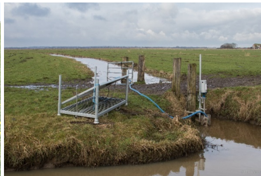
Figuur 3 Pomp op zonne-energie.
