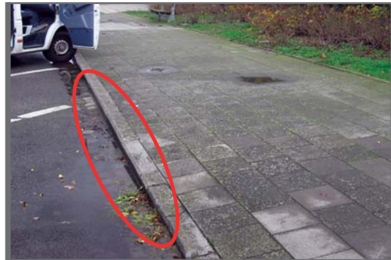
Figuur 3.13 Door de opeenhoping van water, grond en organische materialen vormen aanliggende straatgoten van kleinschalige elementen vaak een voedingsbodem voor onkruidgroei
